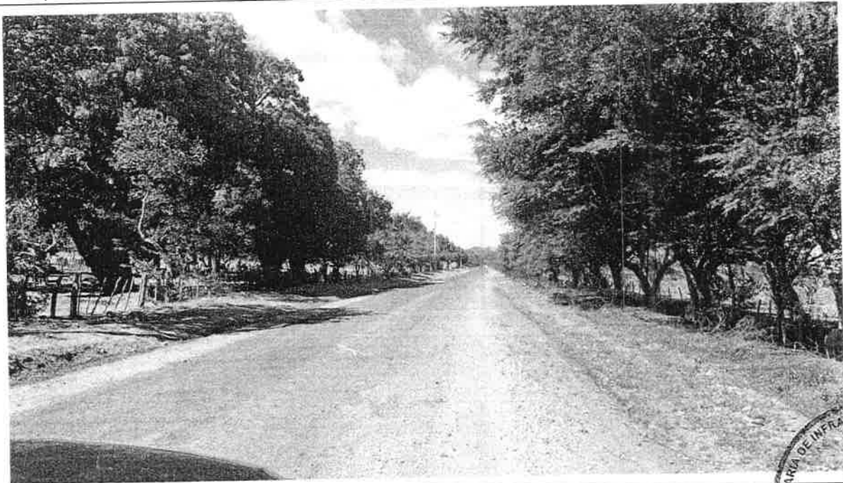
Descripción: Calzada no pavimentada en mal estado, con deformaciones, baches y material suelto producto del tránsito vehicular y de las condiciones climáticas. Monjaras – Punta Ratón
