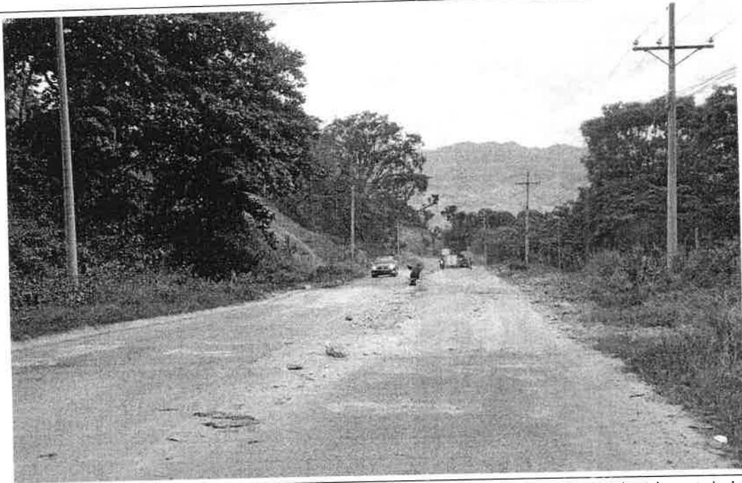
Descripción: Superficie de rodadura con baches de alta severidad, se observa pérdida total de la capeta asfáltica y daños por fatiga o piel de Cocodrilo. Santa Rosa de Copan - Limite Departamental Copan/Ocotepeque Carretera CA-4 | CORREDOR DE OCCIDENTE
